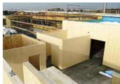
Neue Wände aus Massivholz: Auf die Bestandsdecken wurden die Treppenhäuser und notwendigen Flure (brandlastfrei) inklusive Zwischendecken aus Massivholz montiert. Foto: HU-Holzunion
