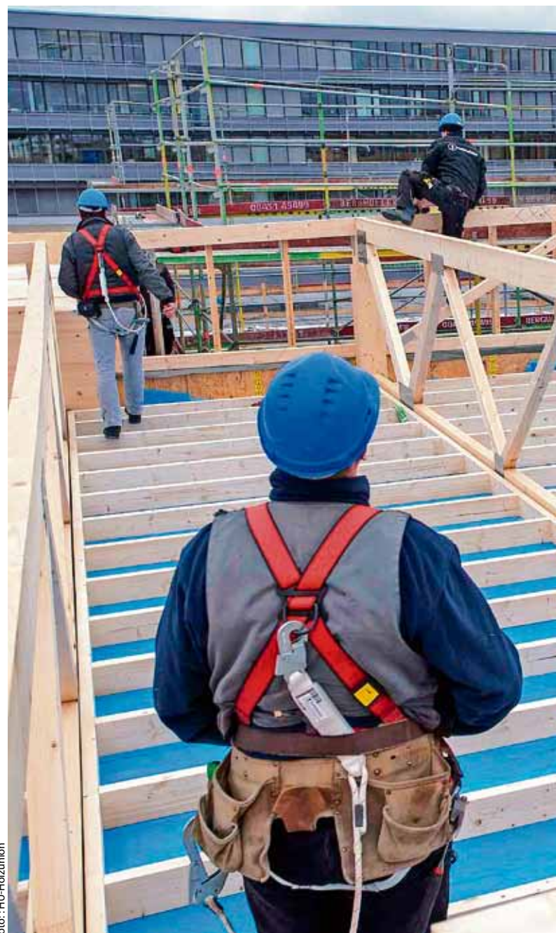
Aufgestockt mit Nagelplattenbindern: Zur Aufstockung wurden teilweise Tragwerkskonstruktionen aus Nagelplattenbindern eingesetzt, die das HU-Partnerunternehmen Cordes Holzbaumaßgenau vorgefertigt und montagebereit geliefert hat. Foto: HU-Holzunion
